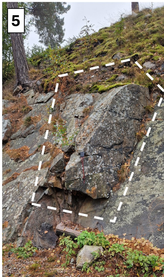
Figur 22. Block 5, flera block som ligger på varandra utan mothåll och lutar brant mot gångvägen.
