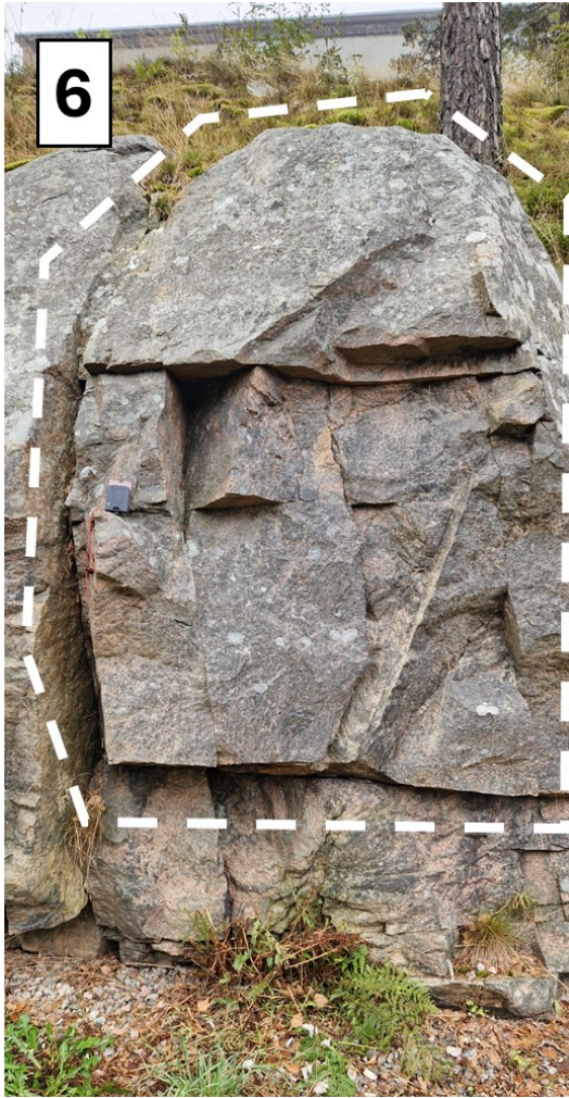
Figur 23. Block 6, större instabilt block som saknar mothåll i släntfot.
