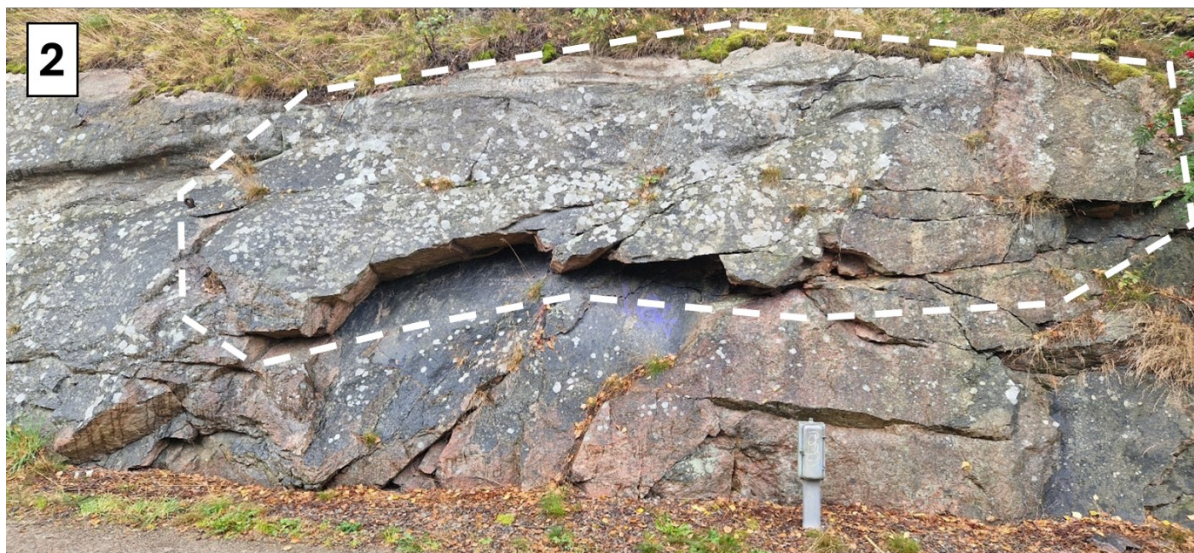
Figur 19. Block 2, större parti av uppsprucket berg som utan mothåll vilar mot ett sprickplan som stupar cirka 60^\circ .
