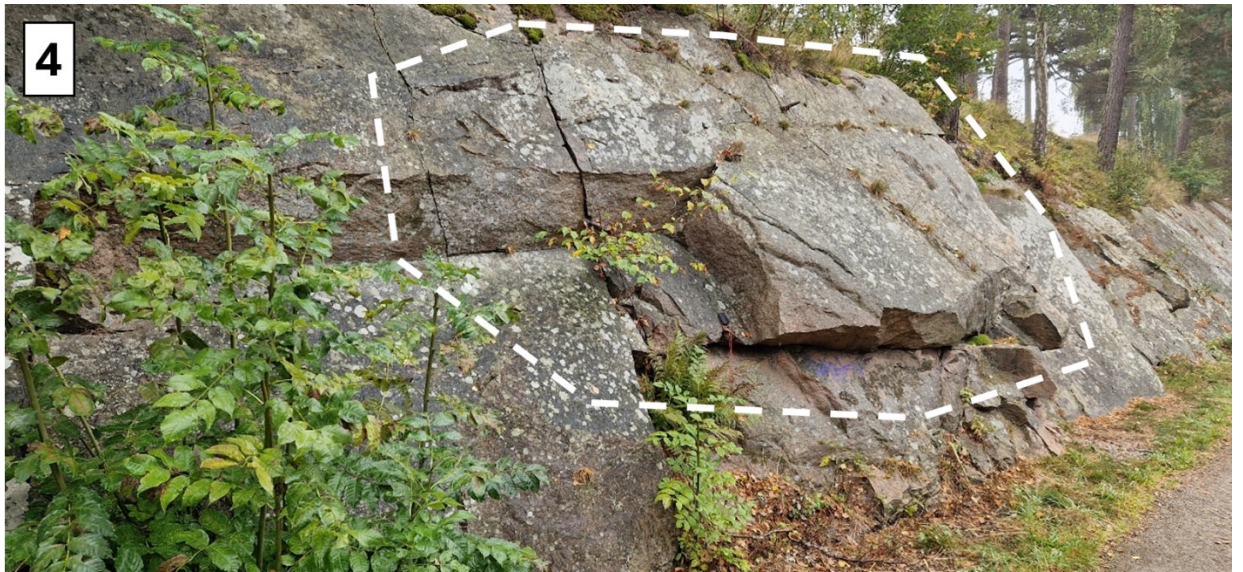
Figur 21. Block 4, stort instabilt block som saknar mothåll i släntfot.
