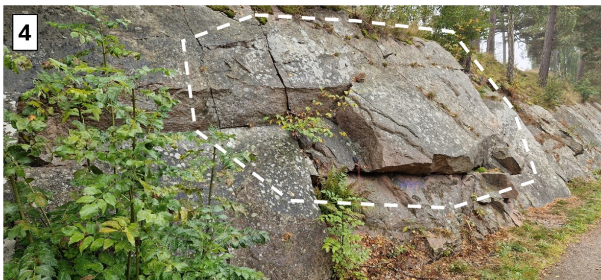
Figur 12. Block 4, stort instabilt block som saknar mothåll i släntfot.
