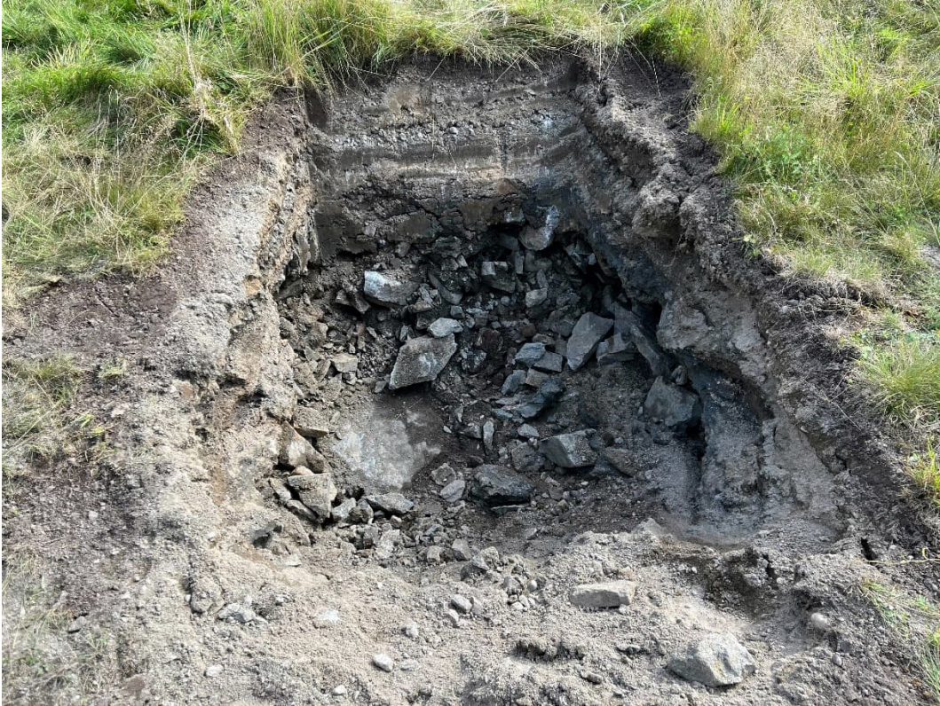
Figur 2. Sprängstensfyllningen ner till 1,2 m djup bedöms huvudsakligen utgöras av sten ( 63 < d < 200 mm) och block ( 200 < d < 630 mm).
