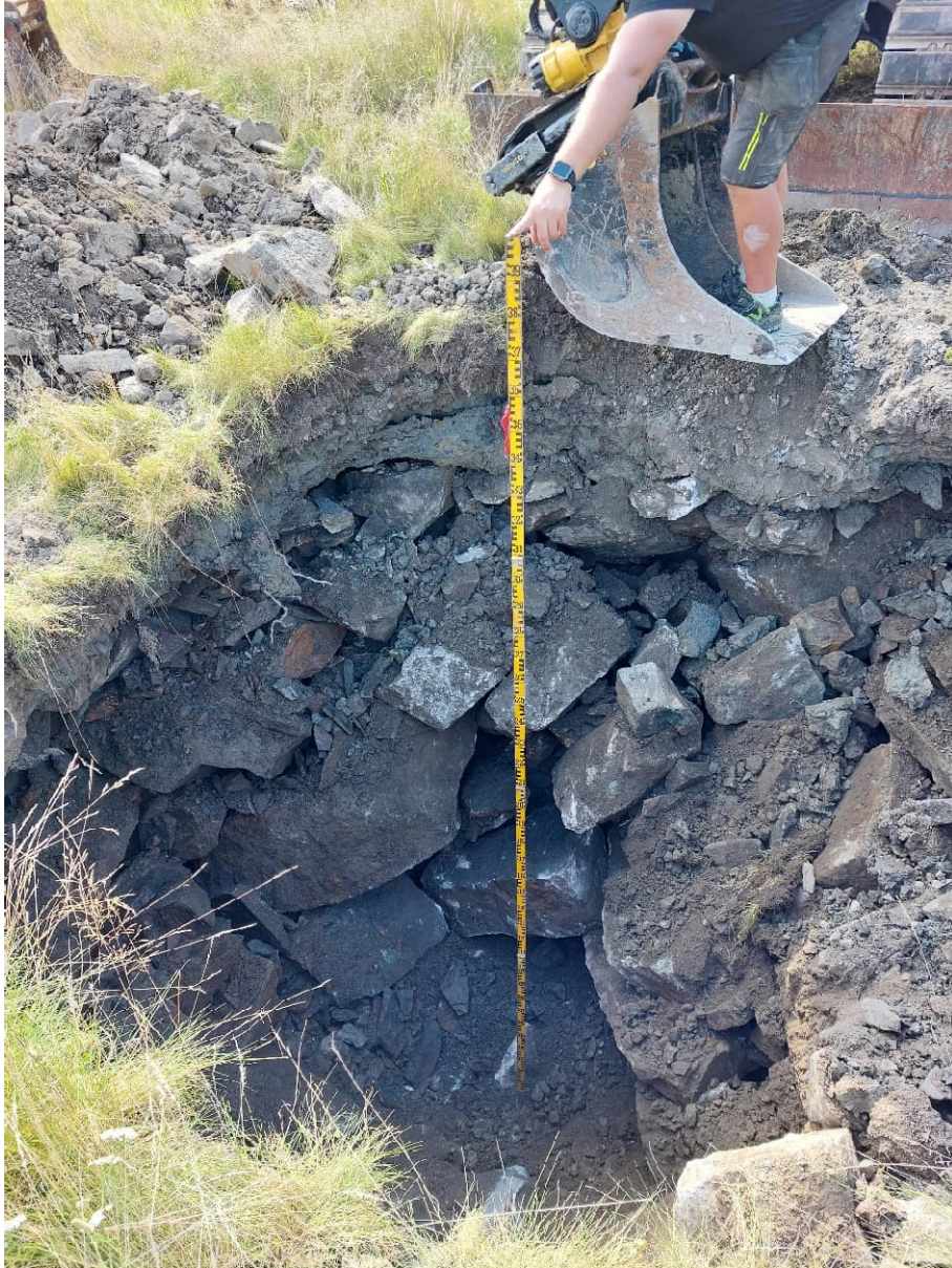
Figur 2. Sprängstensfyllningen utgörs till största delen av block. Mellan blocken finns hålrum utan finare material.
