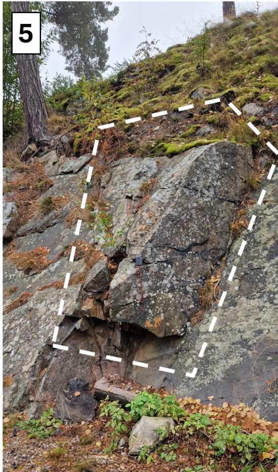
Figur 6. Block 5, flera block som ligger på varandra utan mothåll och lutar brant mot gångvägen.
