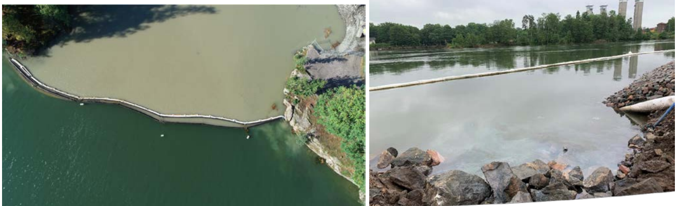
Figur 9 Till vänster siltgardin utanför en grundvik där grävning utfördes i strandkanten. Till höger oljefilm på vattenytan vid schaktning i strandkanten. Utanför ligger siltgardiner med oljelänsa.
