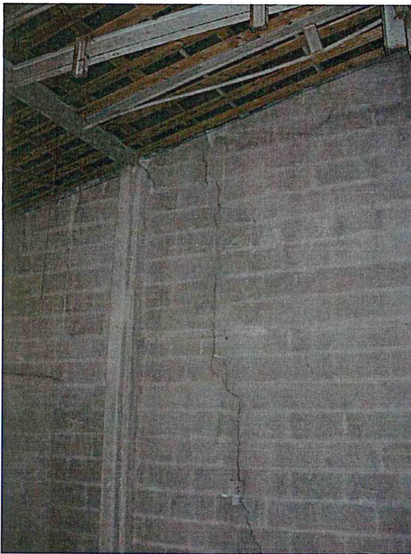
4. Byggnad nr 3 – skador i väggar
