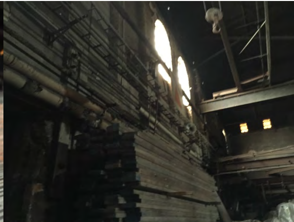
Figur 16. Äldre rör är isolerade med asbestisolering.
