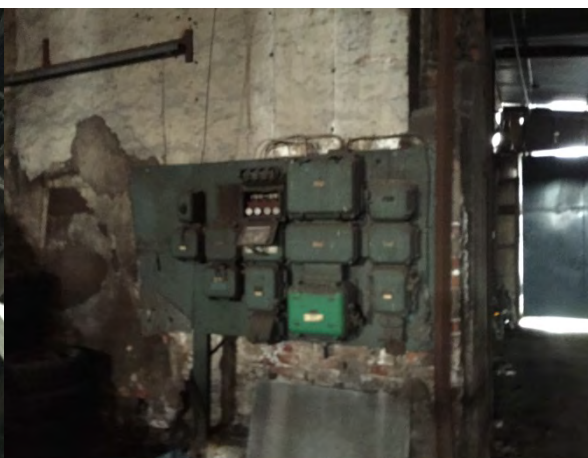
Figur 14. Det finns flera äldre elcentraler och elinstallationer.
