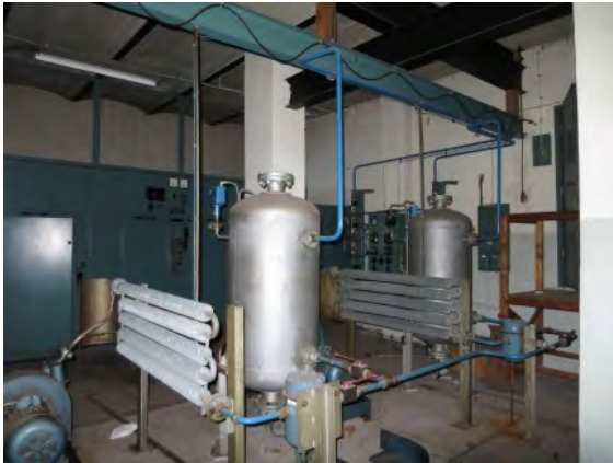
Figur 25. Mindre mängd oljefläckar finns på betonggolv i f d transformatorrum, ingen PCB har påträffats.
