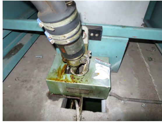
Figur 26. Oljefläckar under traverser och transformatorer innehöll ej PCB enligt analys.
