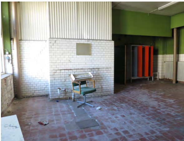
Figur 17. Äldre kakel på plan 1 i kontorsbygganden har asbest i fix bakom kaklet. Kaklet har delvis rasat från väggarna.
