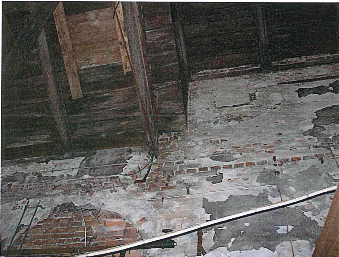
5. Putsskador i hus nr 2
