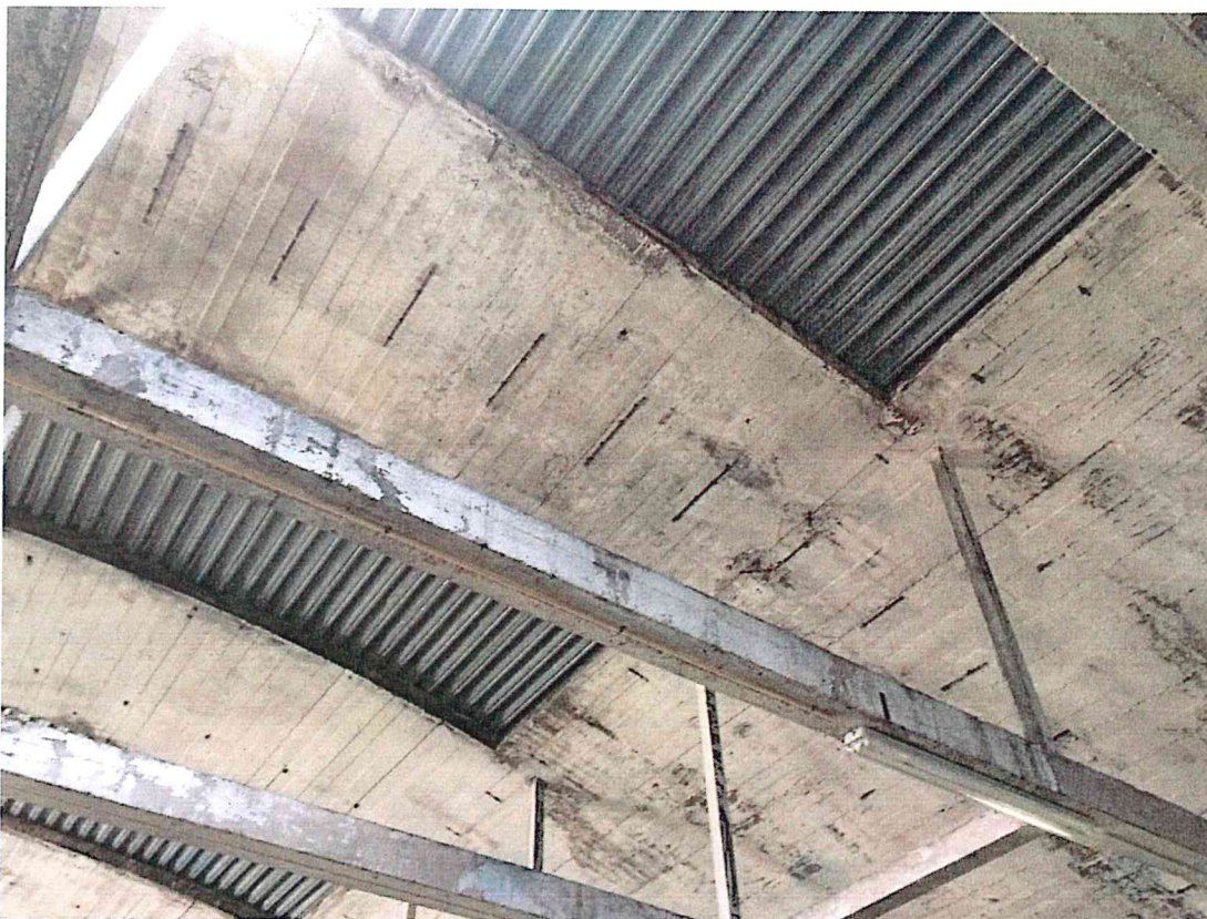
9. Betongvalv, skador vid valvets kant - hus 8 – bilaga 2
