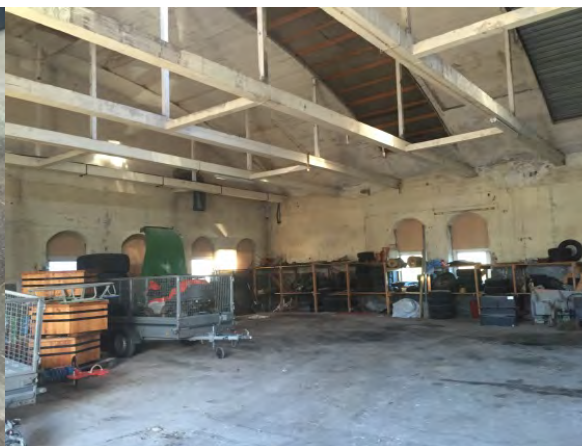
Figur 24. Enstaka små oljefläckar finns på betonggolvet i hallar.
