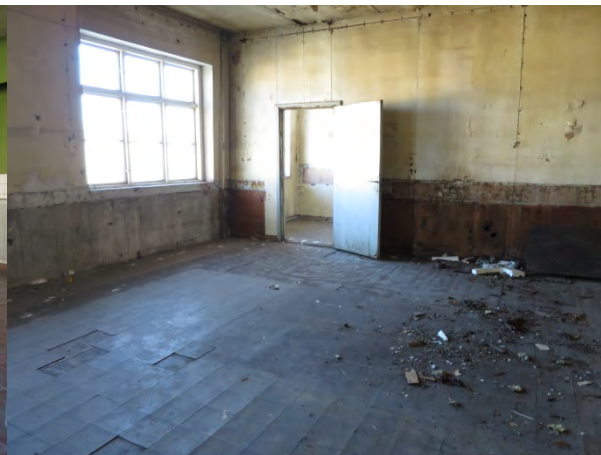
Figur 18. Äldre golvmaterial på plan 2 i rum innehåller asbest, både äldre plattmattor och PVC-mattor.
