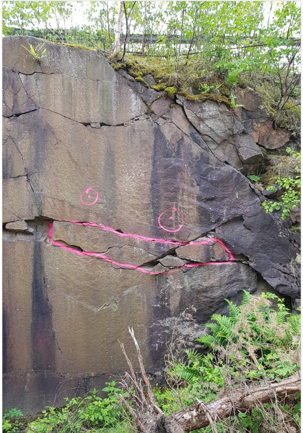
Figur 12. Risk för kilbrott av block inringat med rosa färg.
