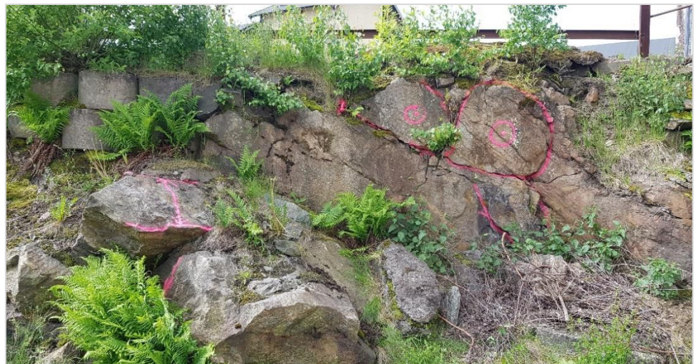
Figur 16. Instabila block i skärningen, markerade med rosa färg.
