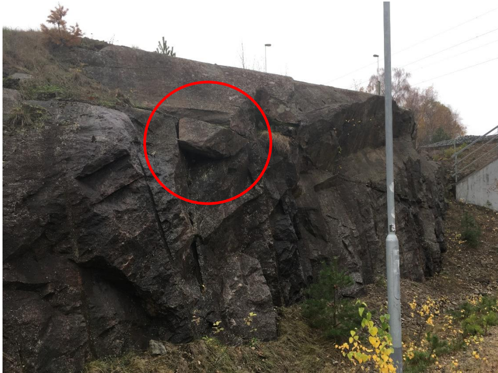
Figur 13 Löst block vid GC-underfart. Åtgärd krävs.
