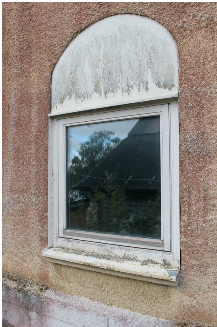
Ett nytt fönster på den östra delen av Sågbladsfabriken i en äldre fönsteröppning.
