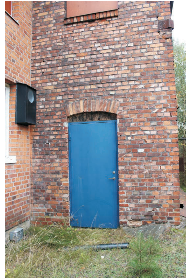
Dörren in i Transformatorbyggnaden har mönstermurad segmentbåge ovanför dörröppningen. Dörren är utbytt.
