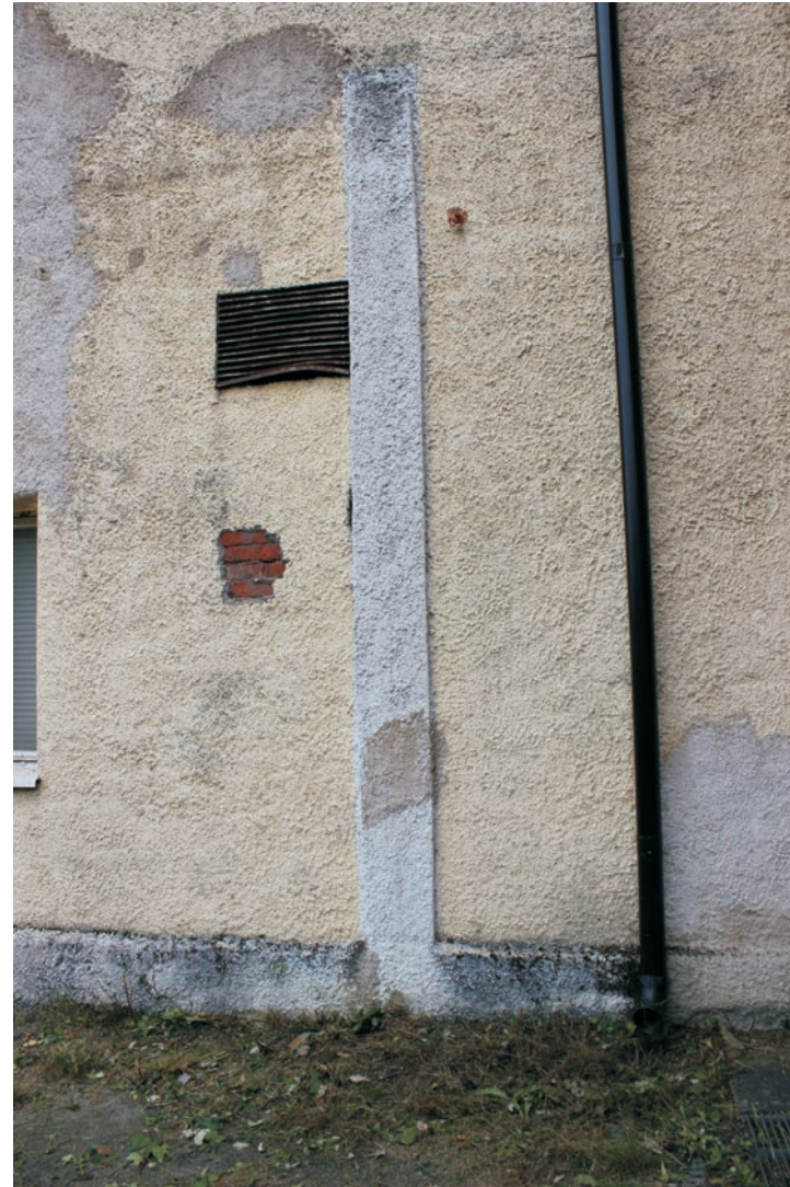
Skada i putsen visar tegelfasad bakom puts.
