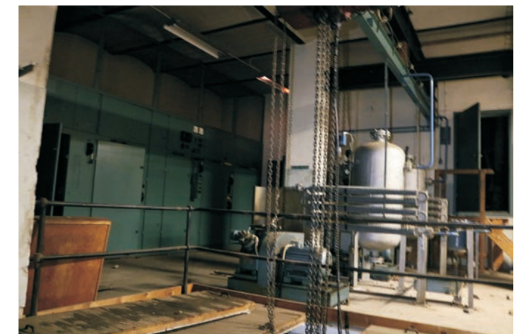
Inuti Transformatorbyggnaden finns det mesta kvar, som om det lämnades igår.
