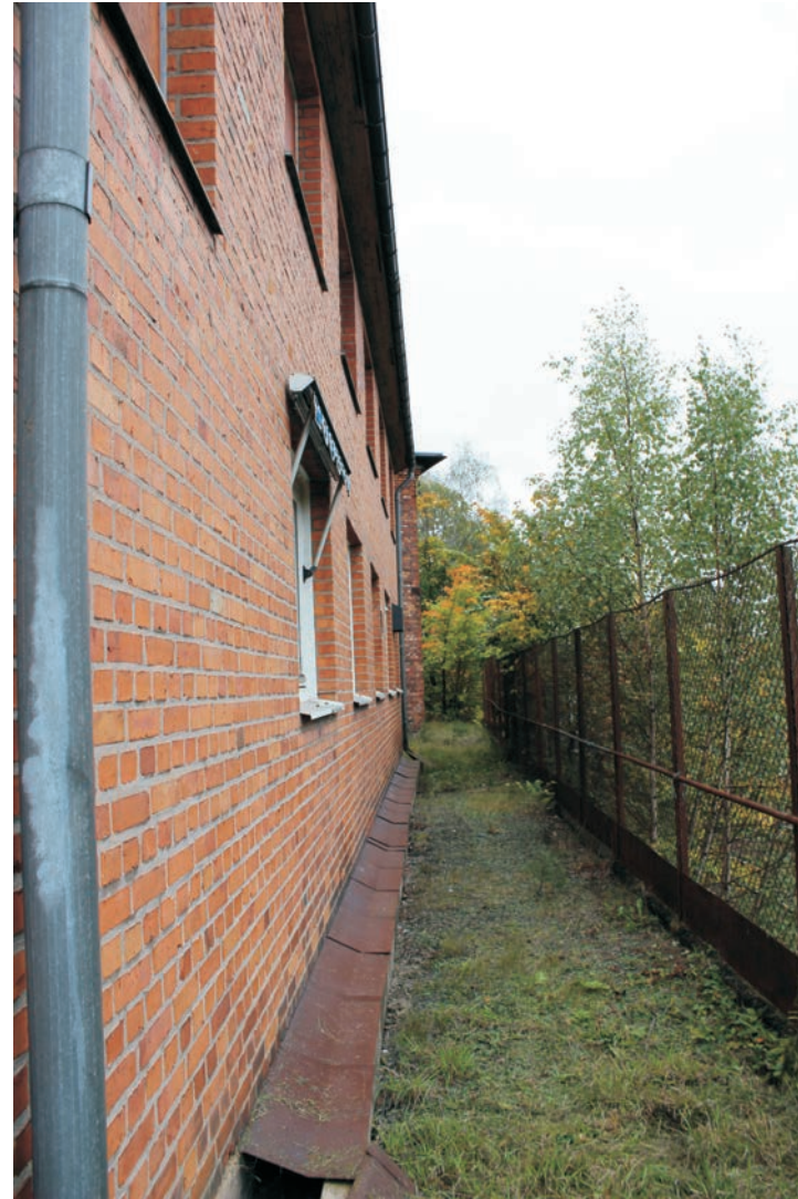
Personalbyggnadens fasad i rött tegel ligger nära det utvändiga stacket. Även Personalbyggnadens tak är belagt med papp. I bakgrunden skymtar Transformatorbyggnaden.
