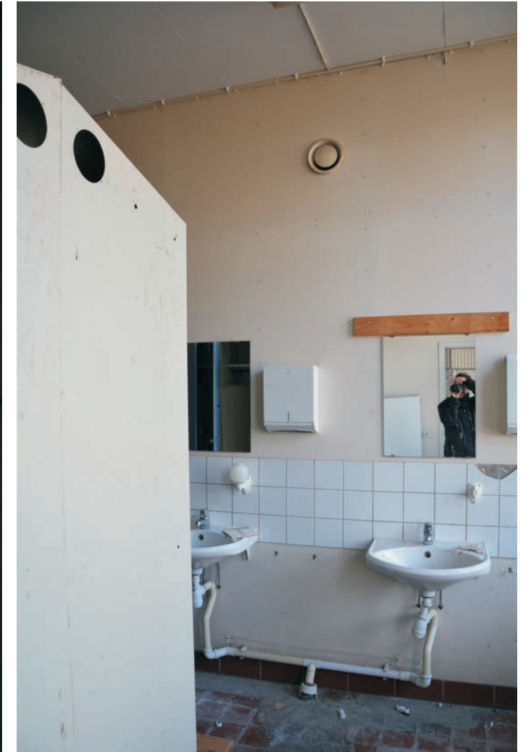
Tvättfaten i den moderniserade delen av personalbyggnaden.
