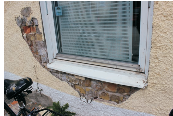
Närbild på skada i puts under fönster på den västra byggnadsdelen. Här finns stortegel i väggkonstruktionen.
