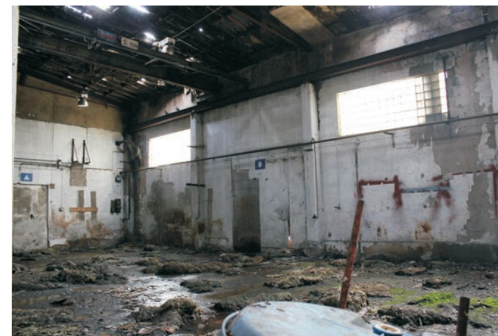
Hallen åt sydost har högt belägna ljusinsläpp i fasaden. Det takljus som sipprar in är inte avsiktligt.
