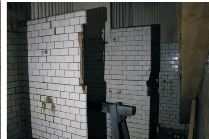
Skador på kaklet.
