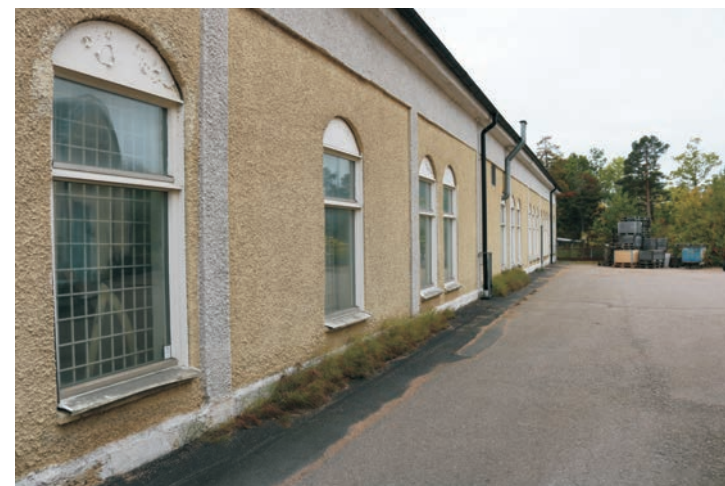
Den västra sidan av den västra delen av Sågbladsfabriken har en rad utbytta fönster i fasaden.
