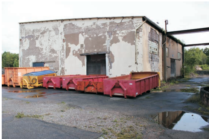
Byggnaden är uppdelad i två lokaler med högt i tak. Taket är platt med svag lutning och troligen belagt med plåt. Här syns tre större öppningar in i byggnaden. En har en skjutdörr, en har en port och den tredje är igensatt, men har varit en skjutdörr.
