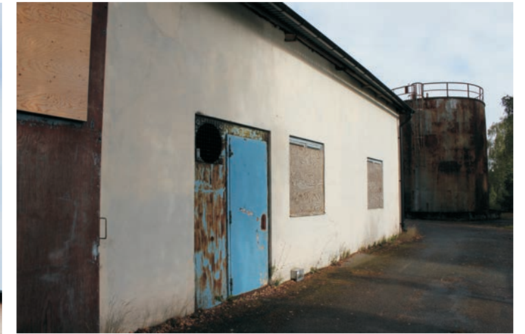
Byggnaden från sent 1950-tal med putsade fasader och plåttak har igensatta fönsteröppningar, men fönstren finns kvar bakom masoniten. Likaså dörren skulle kunna vara i original.
