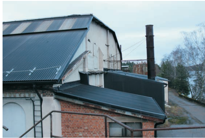
Här syns tydligt takförändringen som skett. Dessutom syns att den övre delen av fasaden har en grövre puts än den lägre delen.
