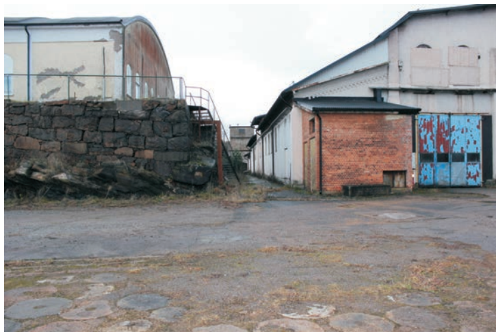
Påbyggd mindre byggnad i tegel i Martinverkets sydöstra hörn. Vid Martinverkets takfot syns att det varit en påbyggd del för svänghjulet som legat med ett svagt sluttande takfall utmed byggnadens längsida. Idag är den tilltäppt av plåt.
