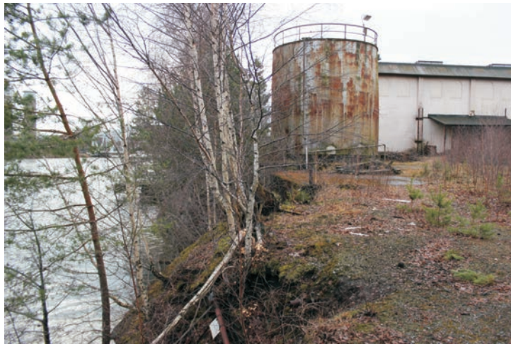
Alldeles nära strandkanten vid Göta Älv står en rund oljecistern i plåt.
