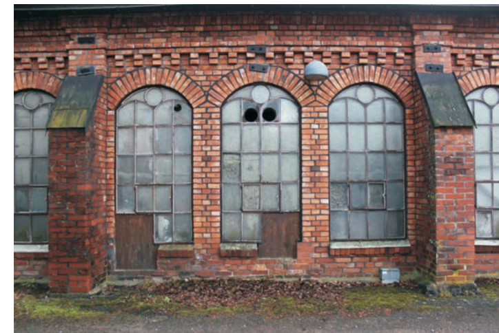
Originalfönstren på norrfasaden har modifierats under årens gång med olika behov som uppkommit.
