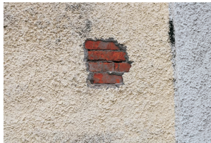
Närbild på skada i puts med tegelfasad bakom.
