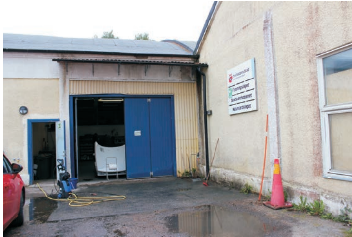
Det vänstra hörnet på anläggningen har en större och en mindre dörr. Här syns spritputsen tydligt på väggarna.
