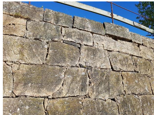
Detalj av mur, blocksten i toppskift ur läge.
