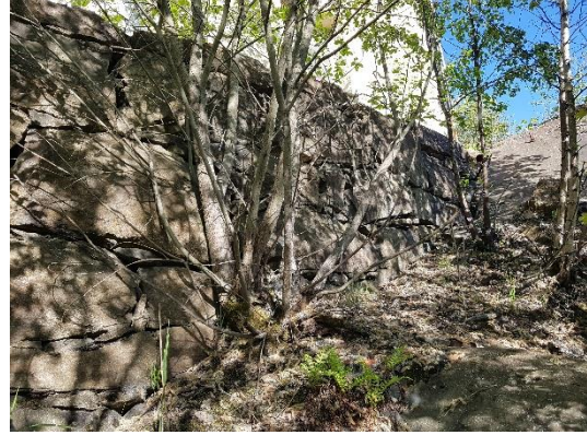
Uppväxt sly intill mur mot söder.
