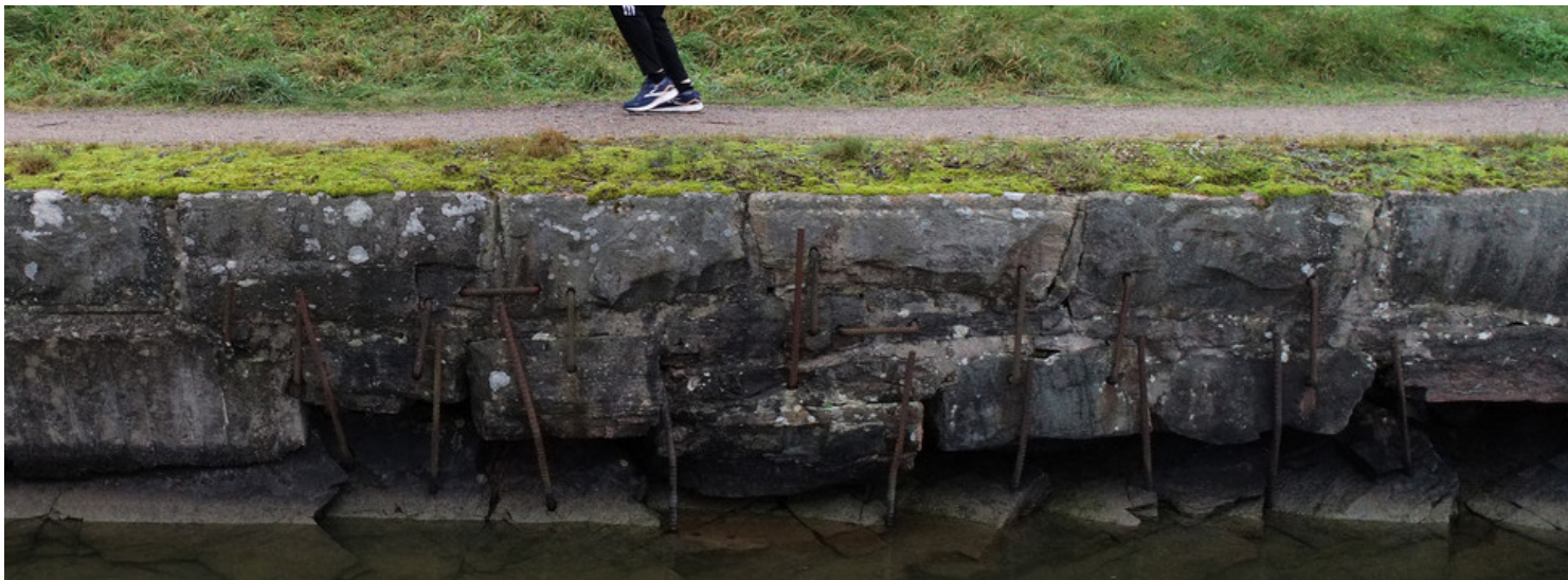
Figur 69 Inom sträcka 27 har dragvägen och muren återuppbyggts efter arbeten som sannolikt genomförts på 1970-talet. Stenarna är fästa med grova armeringsjärn. Dessa murar påverkas av breddningen. Här finns potential att återuppbygga dragväg och mur på ett mer varsamt sätt. Om det finns andra stenar från Bergkanalen av samma eller liknande typ kan det vara ett bättre alternativ att använda sten som inte har skador. Vid bearbetning av stenarna måste huggning av stenen ställas som krav, de får inte ha en sågad yta,
