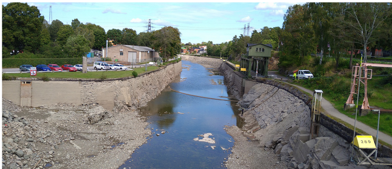
Figur 31 Här syns Olidebassängen i riktning norrut med tömd kanal. Till vänster syns betonglagningar på den gamla kajmuren.
