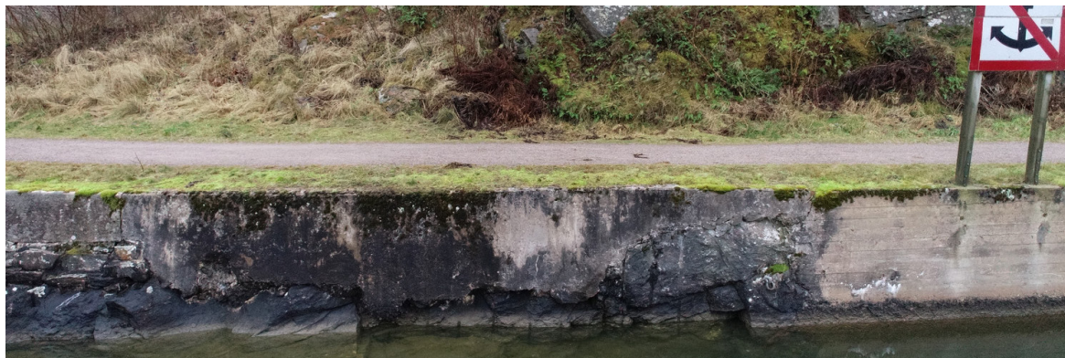
Figur 66 På sträckan finns partier där ingrepp och lagning gjorts på ett ovarsamt sätt med betong. Här finns potential att återskapa den murade dragvägens kant.
