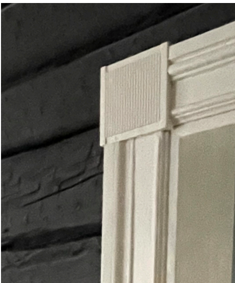
Avvikande dörrfoderkloss i sovrummet. Okänd ålder.
