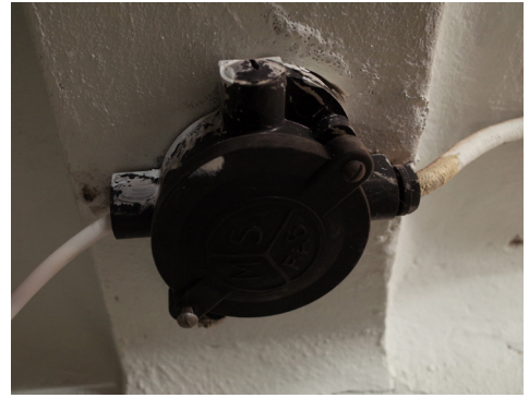
Elektrisk installation från AB ALPHA. 1930-1940-tal.
