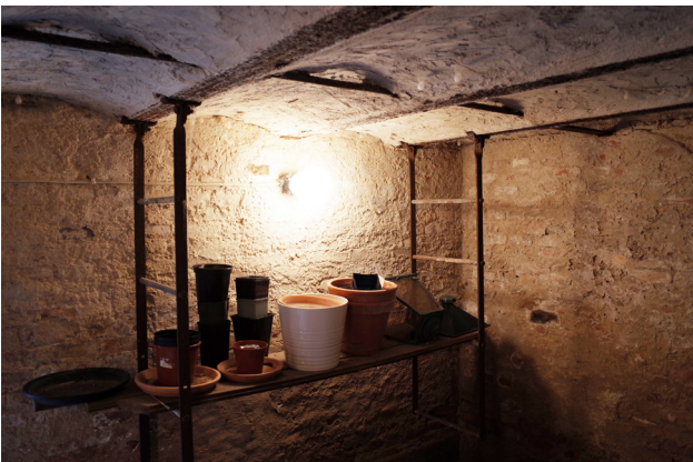
Bremervalv i vedbodens källarvåning. Hyllsystem av järn upphängt i takkonstruktionen.
