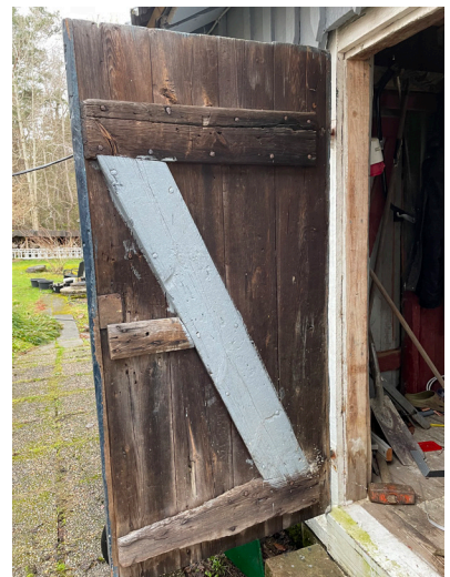
Sliten bräddörr på vedboden. Troligtvis återvunnen från en äldre ekonomibyggnad.
