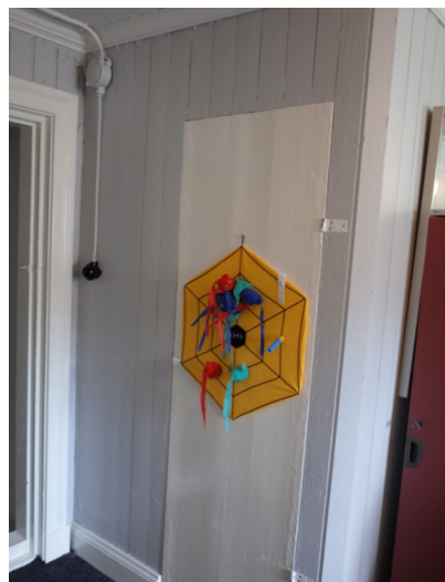
Skafferiutrymme, äldre pärlspontsinredning och elektrisk installation i källaren.
