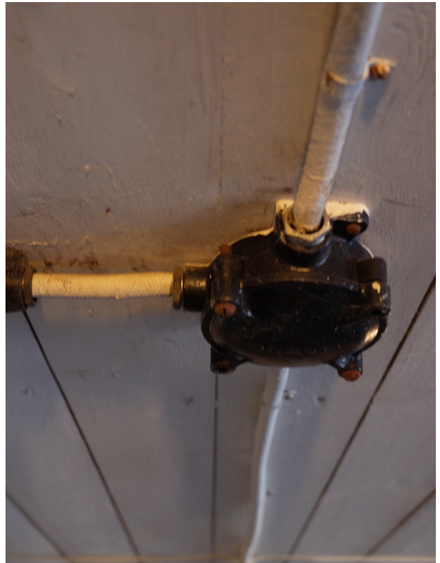
Spår av mycket gamla elektriska installationer i källaren.
