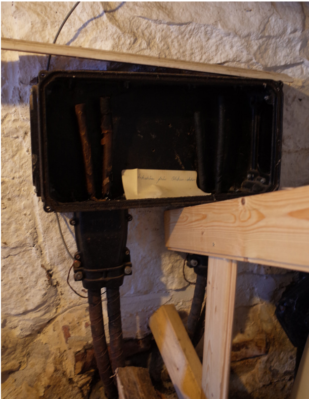
Ålderdomligt elskåp i källaren med en notis som anger att det tagit emot likström direkt från Olidanverket.
