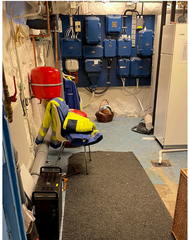
Källarinteriören och tekniska installationer.
