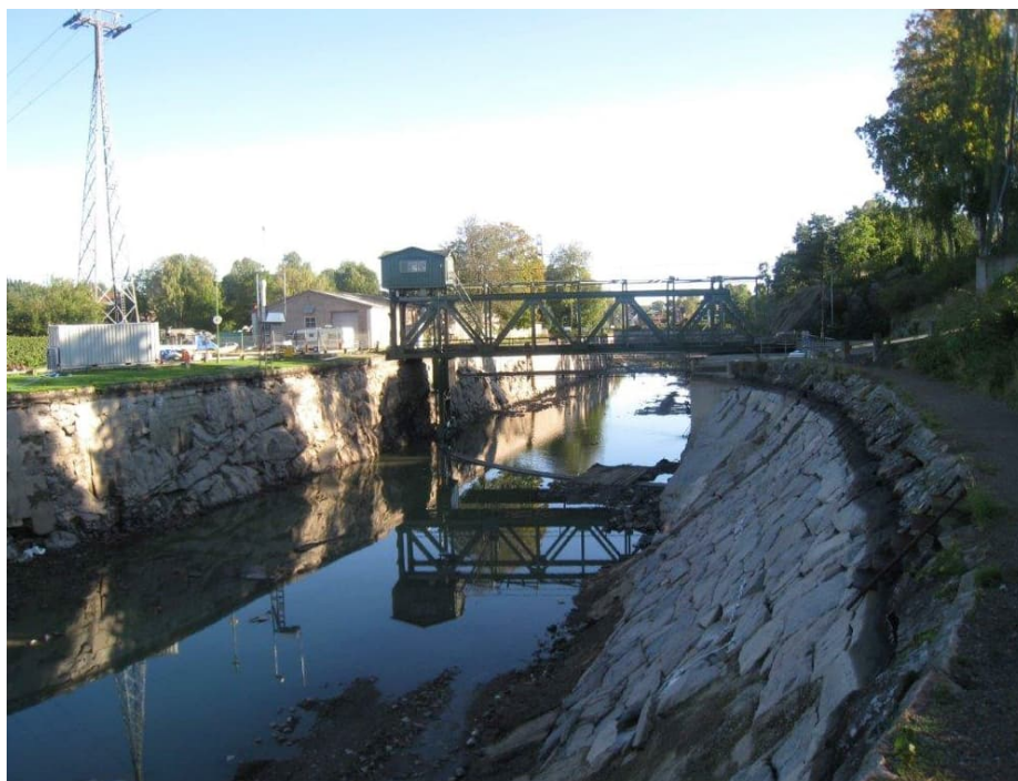
Figur 18. Bergkanalen (tömd på vatten) vid Svängbron. Foto taget mot norr. (Foto: Sjöfartsverket)
