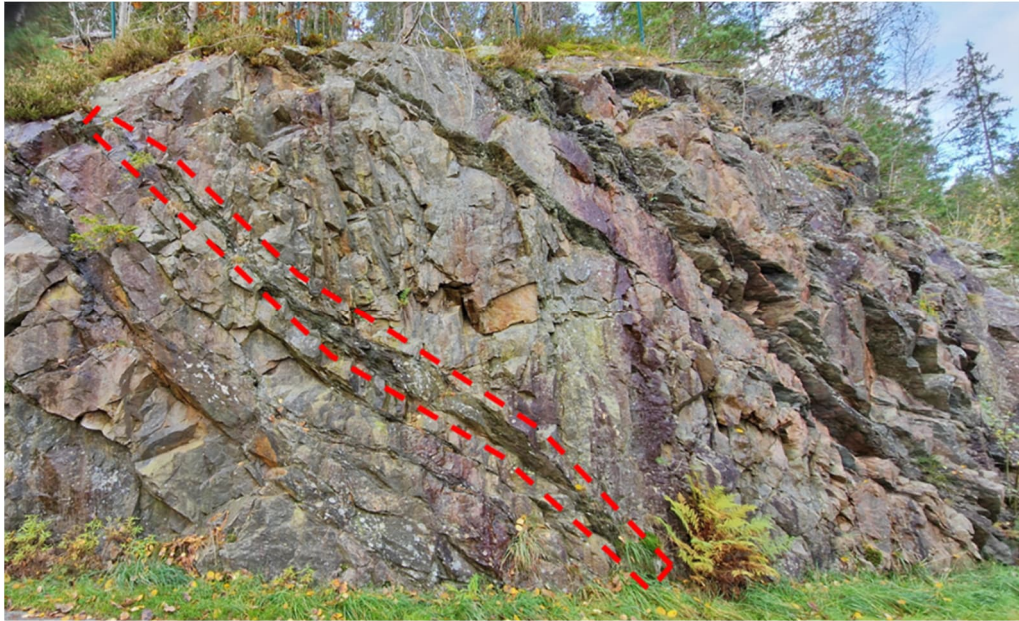
Figur 23. Cirka 30 m bred skärning intill väg, där fyra potentiellt instabila stenar/block förekommer. Röd streckad linje markerar stråket av mer skiffrigt/poröst berg som korsar hela skärningen och är cirka 30 cm tjockt som tjockast.
