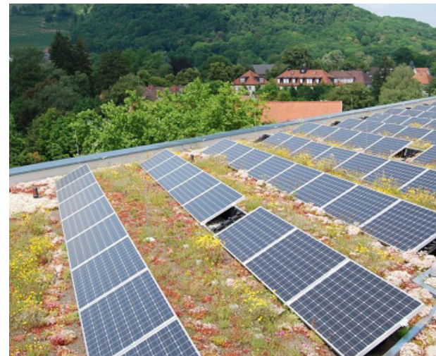
Solcellspaneler i kombination med sedumtak
