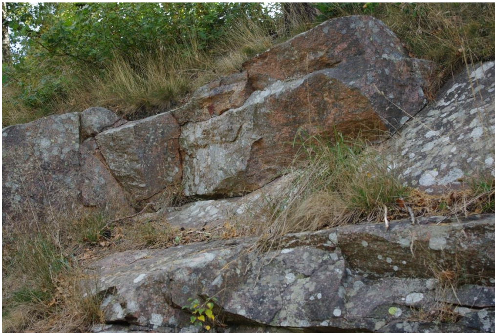
Figur 14: Ytterligare block i samma område som riskerar att glida ut. Foto taget mot öst.
