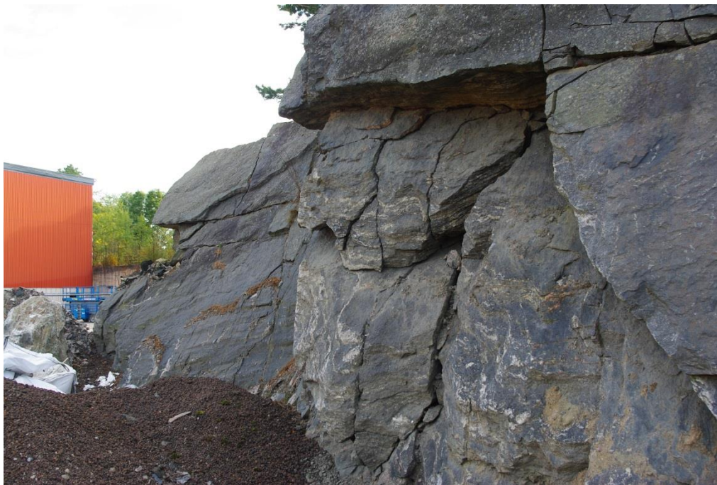
Figur 9: Norra delen i område 2. Partier av instabilt berg i skärningen, där det finns stor risk för utfall. Foto taget mot ost-nordost.
