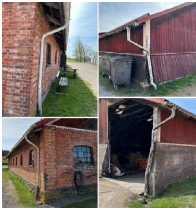
Figur 5. Befintliga stuprör på gårdsbyggnaderna för avvattnings av takytor till internt ledningsnät, Foto: Norconsult.
