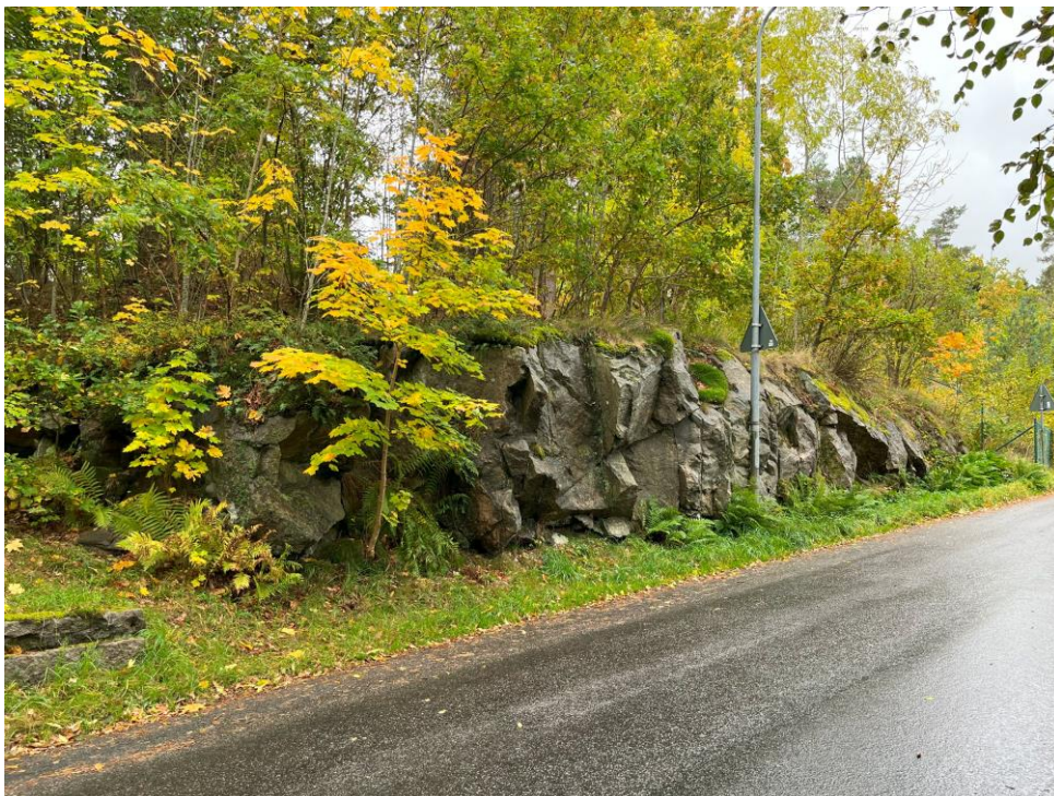
Figur 3. Den östra skärning som visar block som på sikt bör bultas fast.
