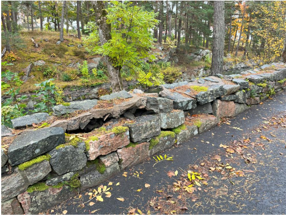
Figur 20. Exempel där det fallit ut sten ur muren.
