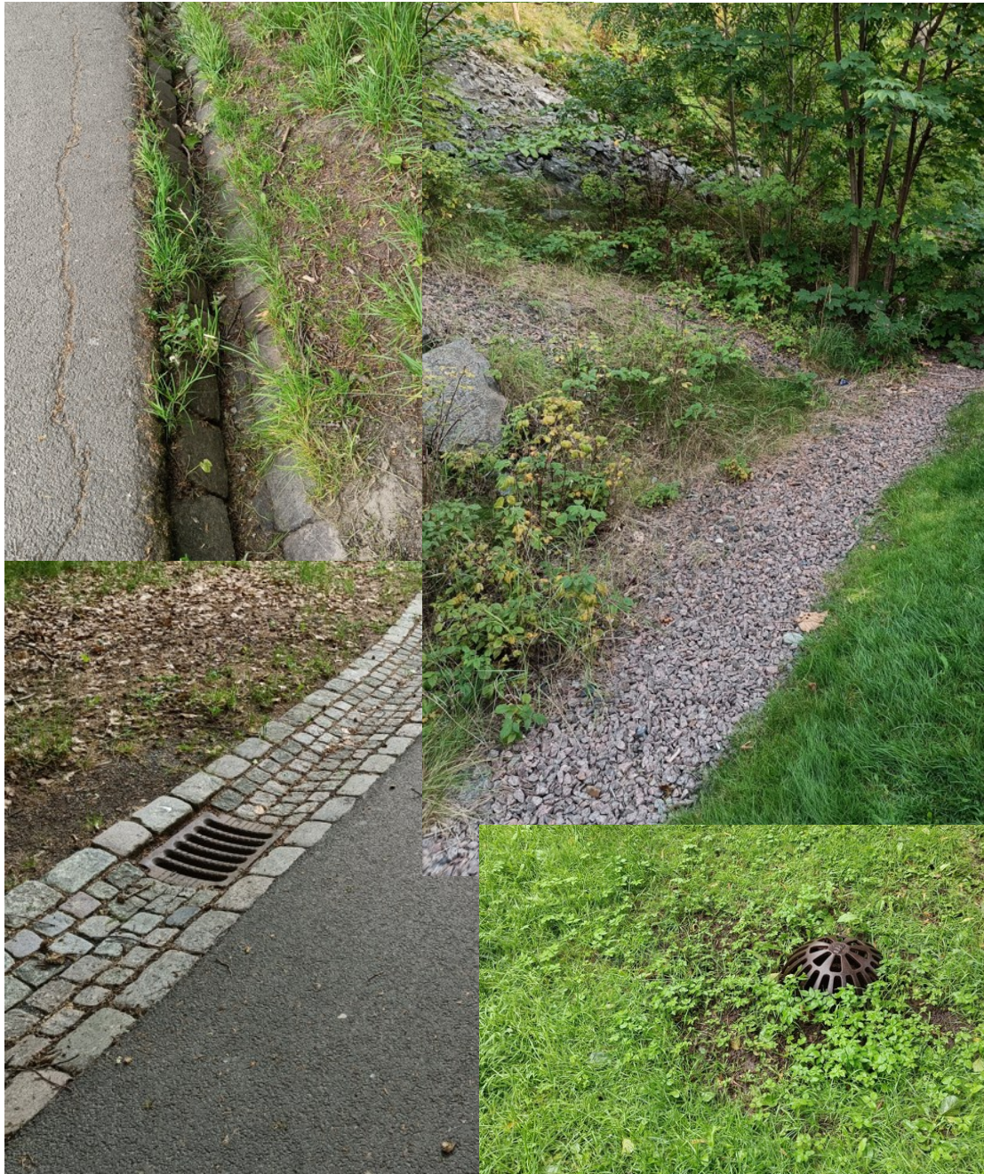
Figur 27. Bilderna visar exempel på rännor längs med gator och makadamdike som kan fånga upp och leda bort vatten i tomtgränser samt en kupolbrunn i lågpunkt på gräsyta.
